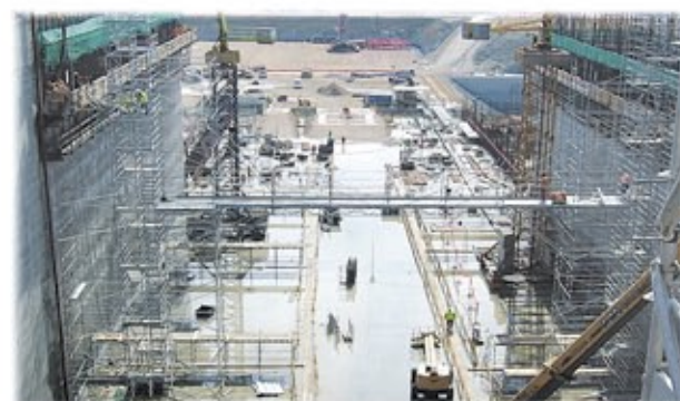
Andamio diverso en plataforma proceso de gas. Algeciras
